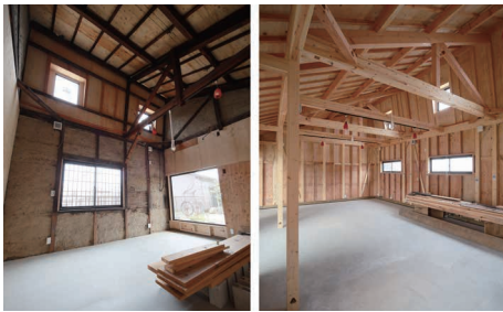
工事中の現場。以前の木組み構造はできるだけ再利用した(左)。増築部分は以前の木組み構造とそっくり設計した(右)
